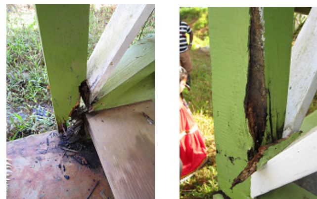
Material de nueva construcción dañado Área de reubicación Charco de la Pava
